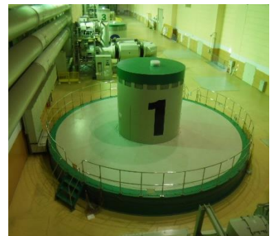
（発電機上部写真）
